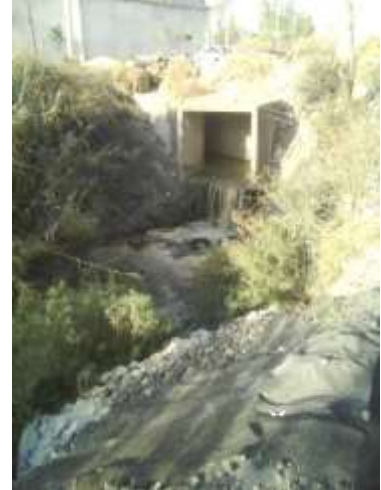
Ilustración 18. Colector pluvial en San Bartolomé
